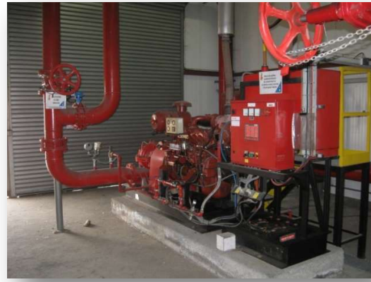
Detall estació de bombeig
