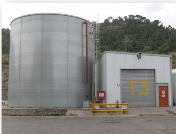
Dipòsit i estació de bombeig sistema contraincendis
