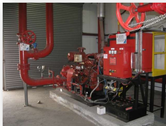
Detall estació de bombeig
