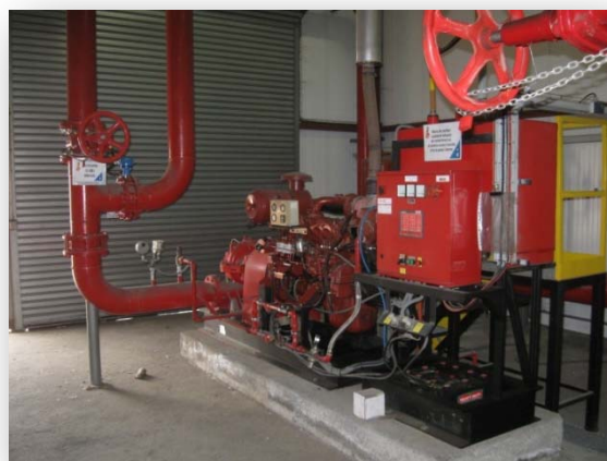
Detall estació de bombeig
