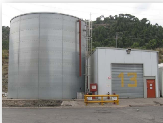
Dipòsit i estació de bombeig sistema contra incendis
